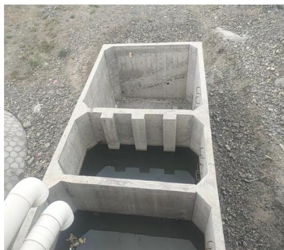
雀尔沟大桥桥面径流收集系统及应急事故池
