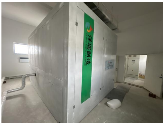
努尔加服务区电锅炉
