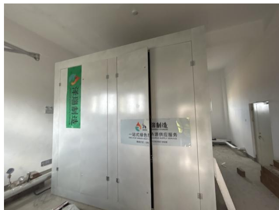
呼图壁主线收费站电锅炉
