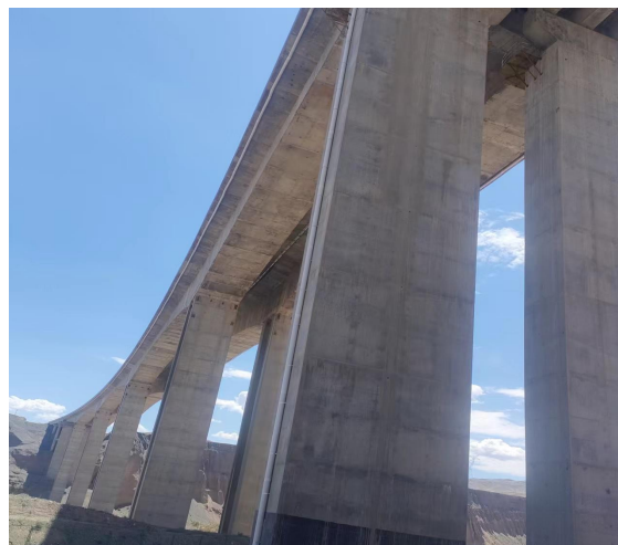
三屯河大桥桥面径流系统
