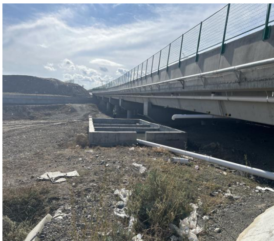
独山子大桥桥面径流收集系统及应急事故池
