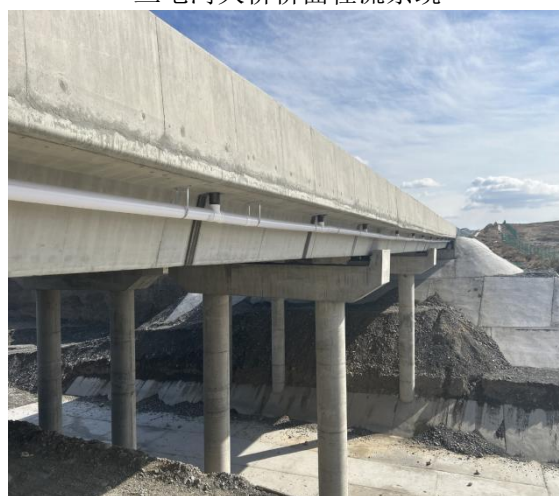
五工台中桥桥面径流系统及排水沟
