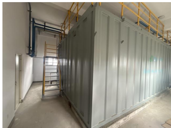
呼图壁主线收费站污水处理设备
