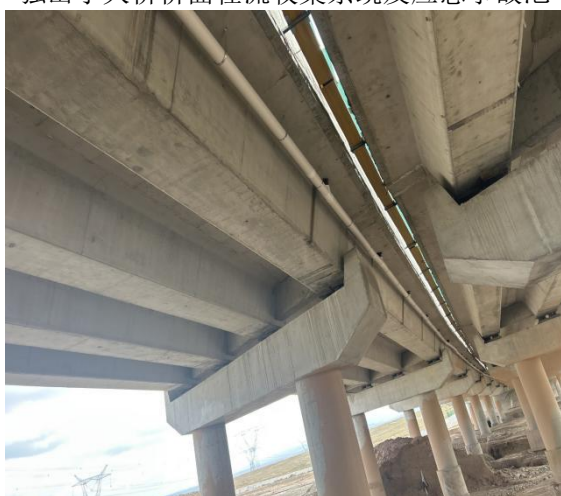
石河大桥桥面径流收集系统
