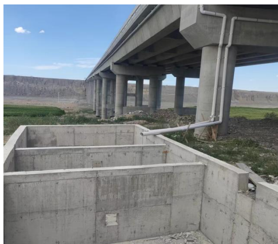
呼图壁河大桥桥面径流收集系统、应急事故池
