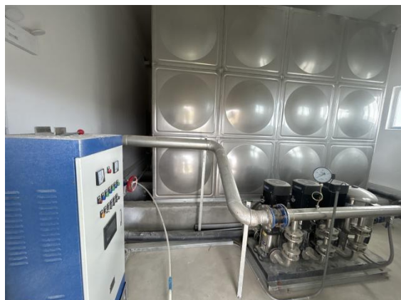
努尔加服务区污水处理设备
